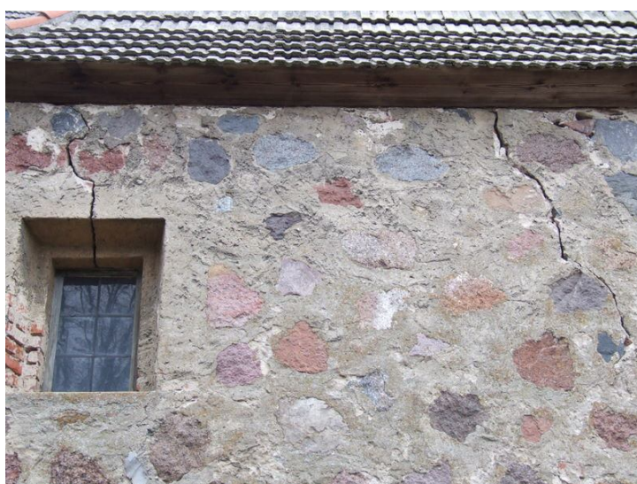
Uszkodzenia elewacji kościoła.
