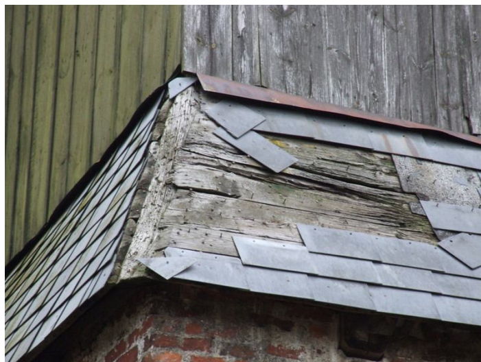
Uszkodzenia wieży kościoła.
